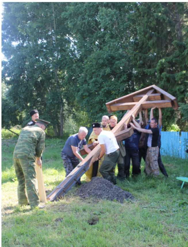
Рисунок 5. Установка поклонного креста на месте сгоревшей Петропавловской церкви в д. Усть-Тара. Фото А. В. Банкрутенко. 2018 год
